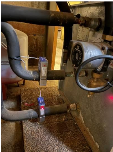
Villa PFLEGER boiler
