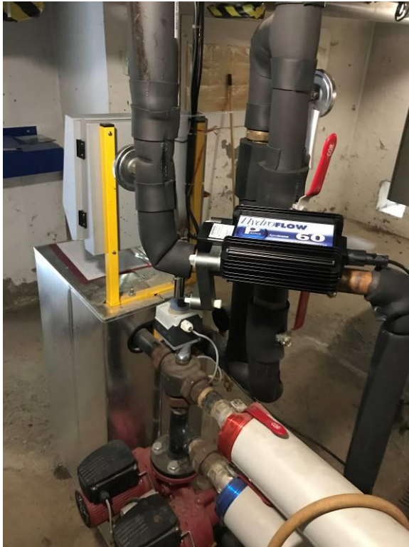
Roseraie 300kW exchanger
