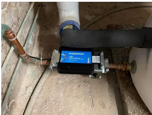
DHW tank Villa des CHENES
